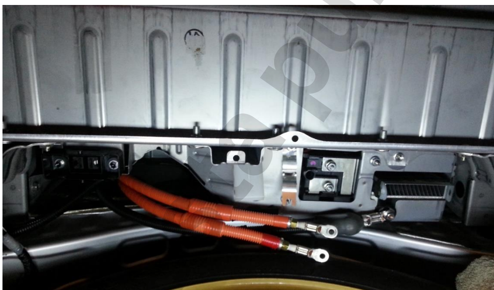
Figura 3-10 – Esempio di sezionamento fisico compiuto sui cavi in uscita dalla batteria di trazione e diretti al convertitore/inverter
